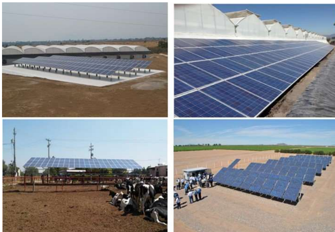
Figura 3: Sistemas fotovoltaicos instalados en granjas agropecuarias (Fotos cortesía FIRCO-SAGARPA).
