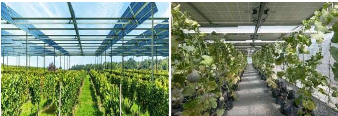
Figura 6: Sistemas Agrovoltaicos donde un AFV se encuentra instalado, de forma elevada, sobre un cultivo agrícola. Imágenes tomadas de [9, 10]
